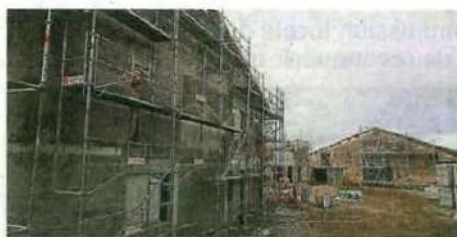
L’ouverture de la résidence accueil de Saint-Pardoux, actuellement en travaux, est prévue pour le mois de mai 2020.
